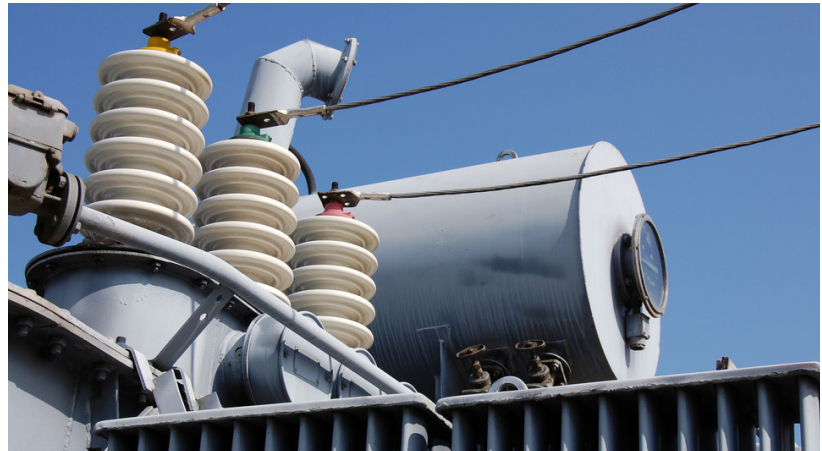
Abb. 13: Hochspannungswandler in einem Kraftwerk: Nahaufnahme von Isolatoren Quelle: © ClipDealer
